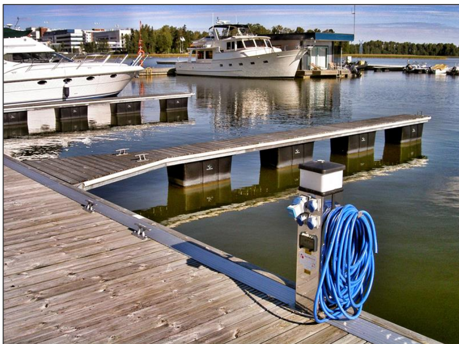
Kuva 1: Esimerkki puomilaiturista sähkö ja vesipisteineen ( https://www.marinetek.fi/ )
